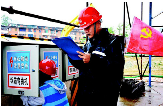
现场巡查安全用电情况
